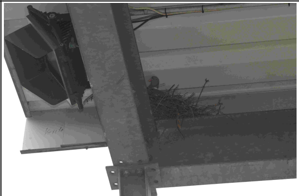
Nest einer Ringeltaube in der Dachkonstruktion der Remise
