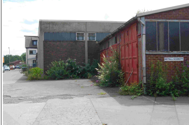
Werkstattgebäude mit älterer Bausubstanz rechts, am Mauerfuß die verbreiteten Pioniergehölze (meist Sommerflieder, Salweide, Birke). Mehrere Einflugöffnungen vorhanden: fehlende Fenster im Nordosten (Torseite) und Südosten, offene Dachlüftung, verzogenes Tor mit breitem Spalt.
