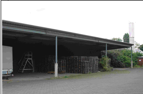
Remise auf der Südwestseite des Gebäudekomplexes, oberhalb der rechten Stütze Taubennest. An 2 weiteren Stellen eingebrachtes Nistmaterial, Nester dort nicht mehr belegt
